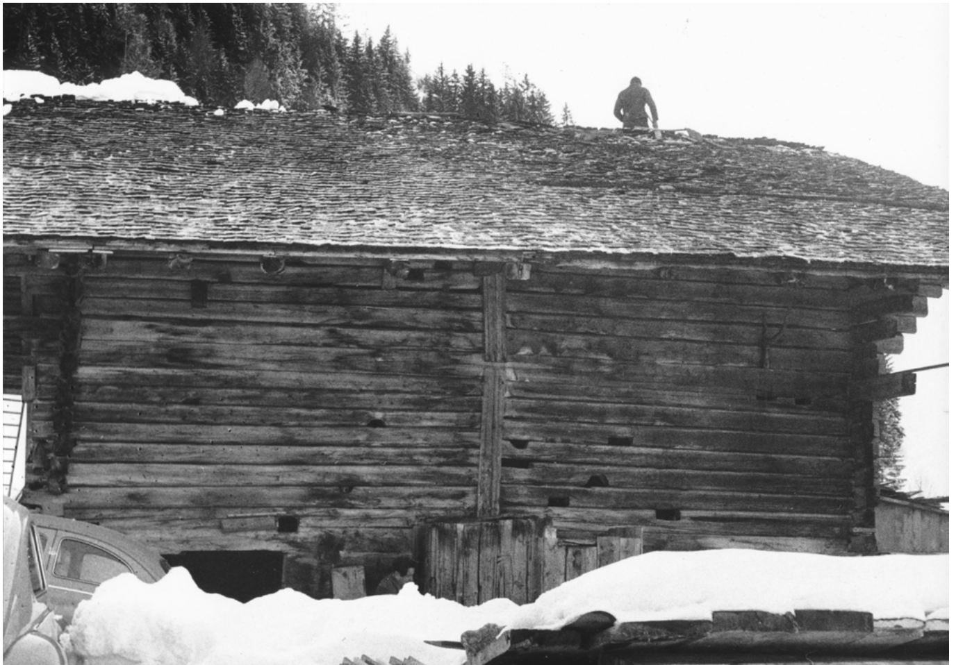
9 Adelboden, Bonderten: Strassenseitige Fassade des Ballenberghauses während des Abbaus. Gut zu erkennen sind die Einschnitte in den Flecken im Bereich der Dili . Blick nach Südwesten. Aufnahme 1967/1968.
