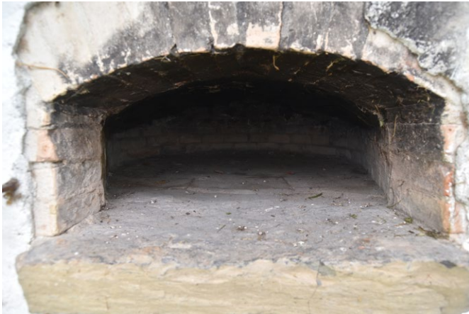
20 Freilichtmuseum der Schweiz, Dörrofen aus Brienzwiler: Blick in den Ofenraum des versetzten Dörrofens aus Brienzwiler. Der Ofenraum ist flach und klein, so musste man vor dem Dörren weniger einheizen und konnte den Holzverbrauch reduzieren. Blick nach Nordosten. Aufnahme 2021.
