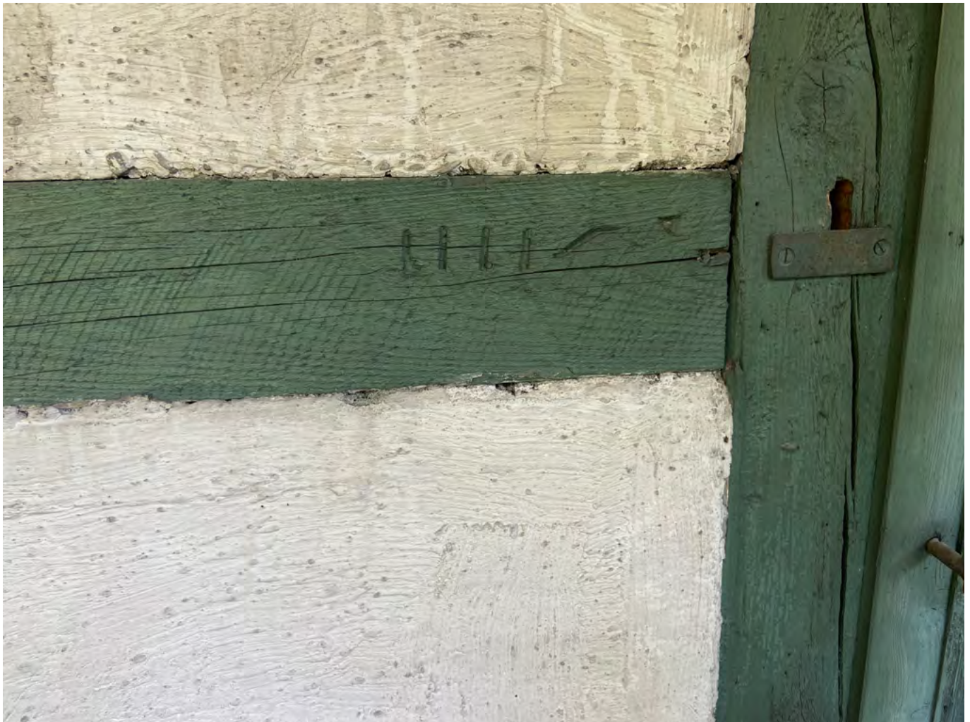
15 Freilichtmuseum der Schweiz, Schmiede aus Bümpliz: Fachwerk mit Abbundzeichen und deutlichen Sägespuren. Das Riegelholz ist fest mit seinem Zapfen im Eckständer befestigt. Einst war das Riegel- oder Fachwerk nicht sichtbar, sondern lag hinter einem Schindelschirm verborgen. Aufnahme 2021.
