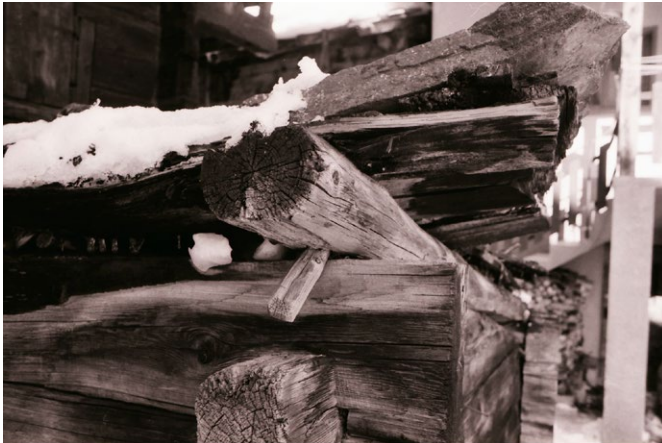
24 Blatten, Schweinestall Ebener: Westansicht des Schweinestalls. Die Dachbalken lagen auf dem Blockbau auf und wurden mit Holznägeln daran gehindert, abzurutschen. Aufnahme 1984.
