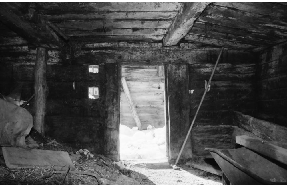
22 Blatten, Heustall Ebener: Das Stallgeschoss. Die Stalldecke war in der Mitte zwischen den Bindern horizontal, rechts und links davon fielen sie wenig gegen unten ab. Blick nach Westen. Aufnahme 1984.
