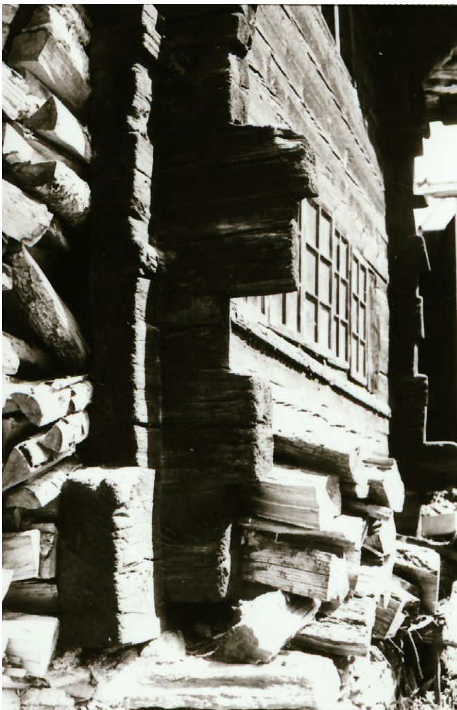
14 Blatten, Haus Ebener: Unregelmässig vorstehende Blockvorstösse an der Südost- und Südwestecke des Stubenblocks, welcher auf der Trockensteinmauer auflag. Aufnahme um 1970.
