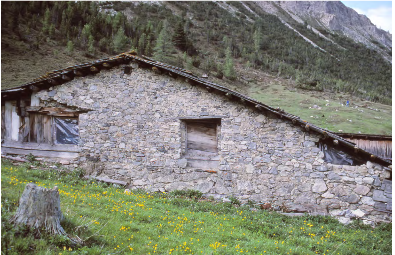
15 Val Müstair, Alp Champatsch: Der Schermen. Im Giebfeld über der Grundmauer, welche in den Hang hineingebaut wurde, ist der Beginn der Blendmauer aufgrund der Baufuge gut zu erkennen. Über die Öffnungen wurde vermutlich das Notheu zur Lagerung eingebracht. Blick nach Süden. Aufnahme 1987.
