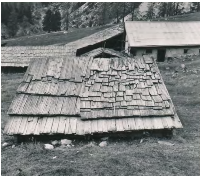
22 Val Müstair, Alp Champatsch: Auf dem Dach des Schweinestalls lagen gesägte Brettschindeln mit Nut neben Spaltschindeln, wie es auch bei den anderen Alpegebäuden zu beobachten war. Blick nach Norden. Aufnahmedatum 1987.
