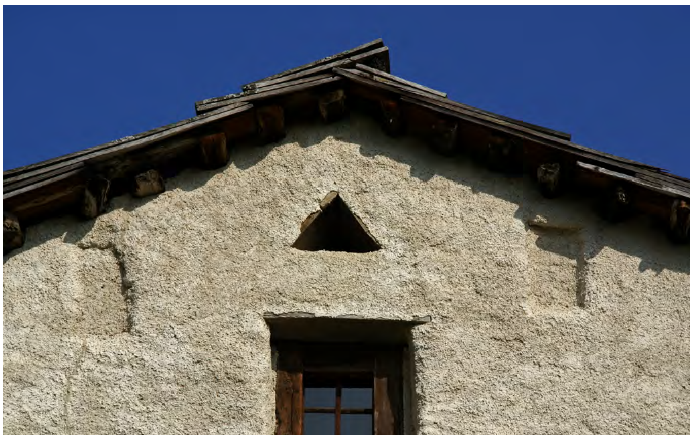
28 Freilichtmuseum der Schweiz, Alpgebäude Alp Champatsch: Die Pfetten der Sennhütte wurden am Museumsgebäude durch einen Rekonstruktionsfehler vertieft versetzt und überputzt. Dies brachte eine bedeutende optische Veränderung der Schauseite mit sich. Blick nach Nordwesten. Aufnahme 2011.
