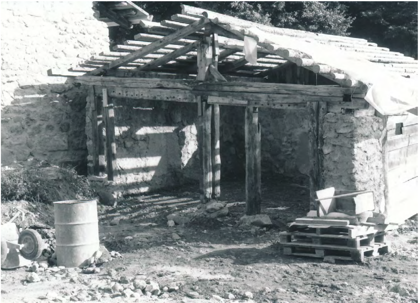
20 Freilichtmuseum der Schweiz, Alpgebäude Alp Champatsch: Beim Wiederaufbau des Alpstalles war vor der Montage der Holzverschalung die Stützkonstruktion sichtbar. Blick nach Norden. Aufnahme 1989 oder 1990.
