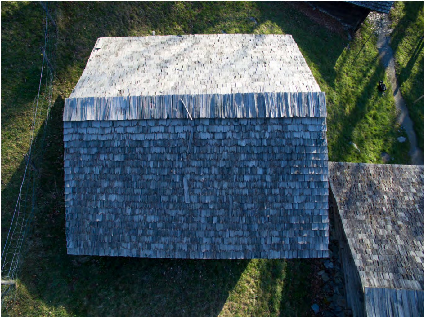
40 Freilichtmuseum der Schweiz, Alpgebäude aus Bellwald: Bei allen translozierten Gebäuden war die Schindeldeckung schadhafte und musste neu aus handgespaltenen Lärchenschindeln, dem Bestand entsprechend, hergestellt werden. Aufnahme 2016.
