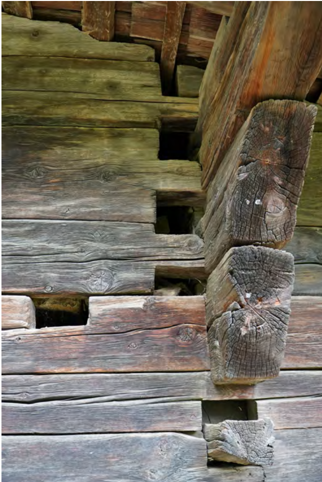
36 Freilichtmuseum der Schweiz, Sennhütte/Käselager, Nr. 1345: Detail an der Südfassade. Die Hölzer von Binnenwand und Gebäudefront passten schon am ehemaligen Standort nicht aufeinander. Der Grund könnte in einer früheren Gebäudeversetzung liegen. Aufnahme 2022.
