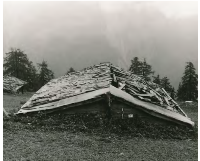
34 Bellwald, Alp Richinen: Die Dachdeckung aus Langschindeln auf dem Alpstall, Nr. 1344, war auf der westlich gelegenen Dachhälfte zum Zeitpunkt des Rückbaus bereits stark beschädigt. Blick nach Südosten. Aufnahme von 1984.
