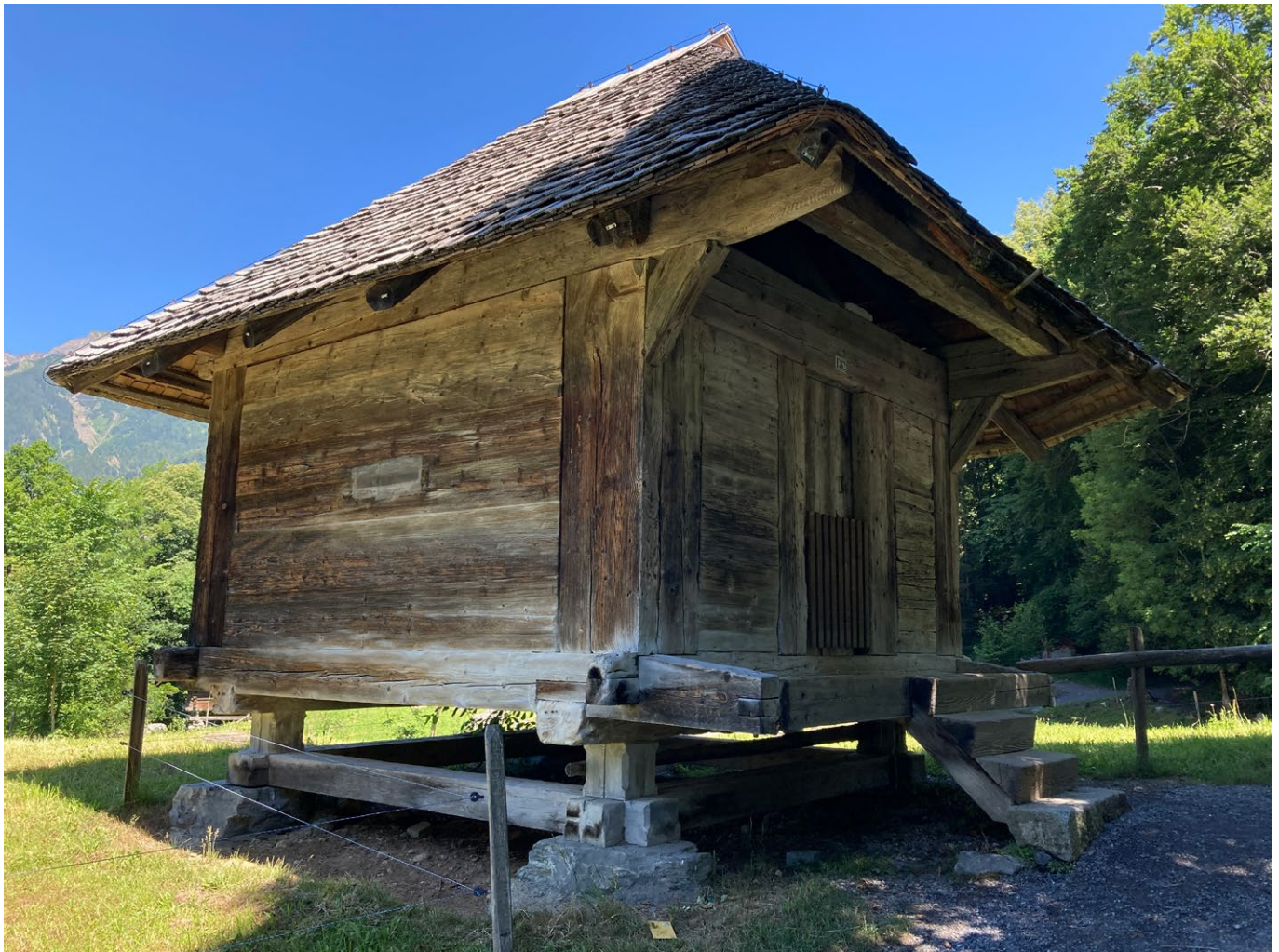
16 Freilichtmuseum der Schweiz, Käsespeicher aus Leissigen: Der Käsespeicher aus Leissigen hat eine neue Unterkonstruktion und Dachdeckung erhalten, da das Bestandsmaterial für eine Translozierung nicht mehr geeignet war. Blick nach Norden. Aufnahme 2022.
