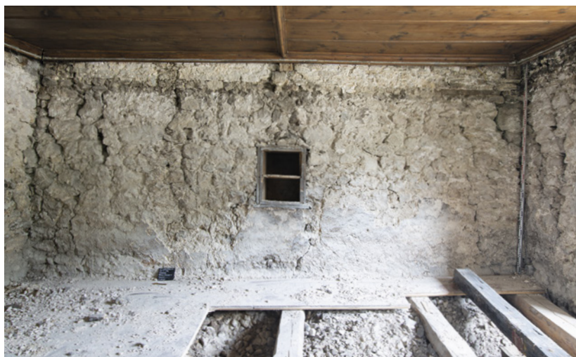
5 Petit-Val, Châtelat, Milieu du Village 4. Chambre de l'étage. Rehaussement de la pièce et limite du plafond de la phase 1. Vue vers l'est.
